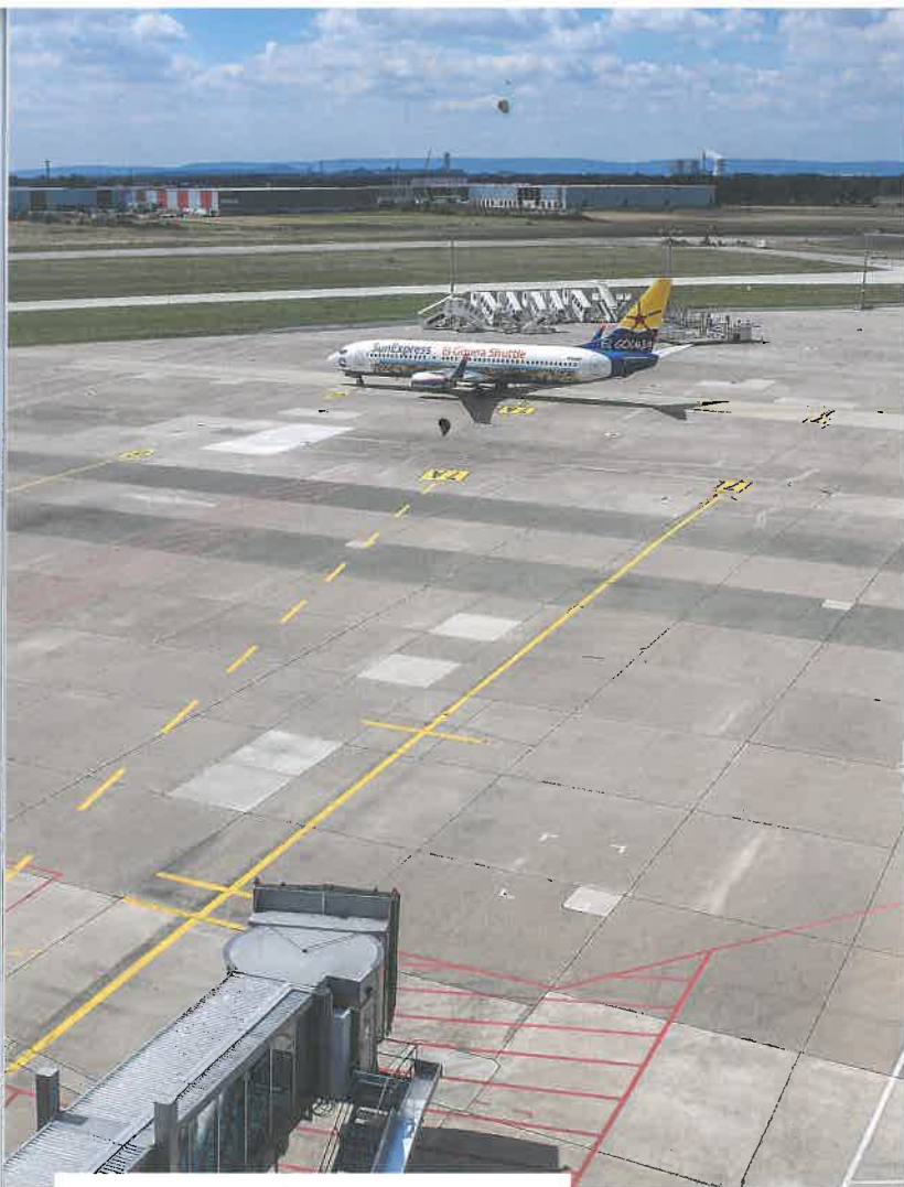
Das große Vorfeld erfordert immer wieder punktuelle Sanierung.
