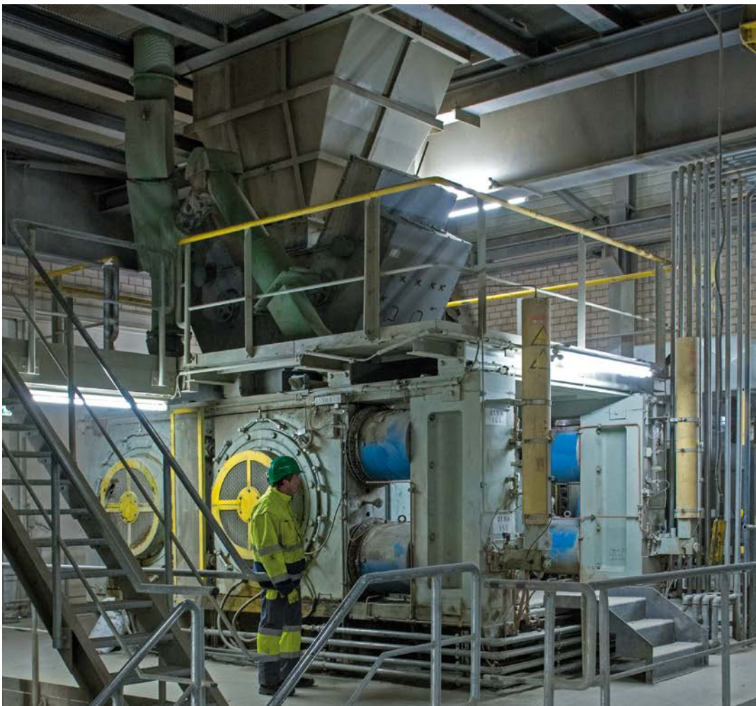
← Mit dem Einsatz der von HeidelbergCement mitentwickelten Gutbettwalzenmühlen-Technologie liegt der Strombedarf bei der Zementmahlung um einiges niedriger.
